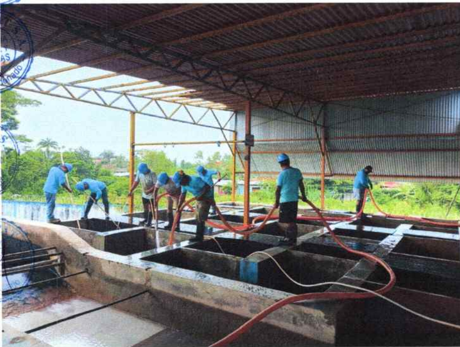
IMAGEN N° 17 Limpieza y lavado del Floculador. 27/12/2024
