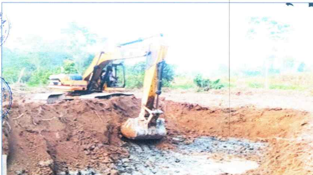
IMAGEN N° 25 Construcción de estanques para crianza de peces predio del Sr Celestino Mendoza
