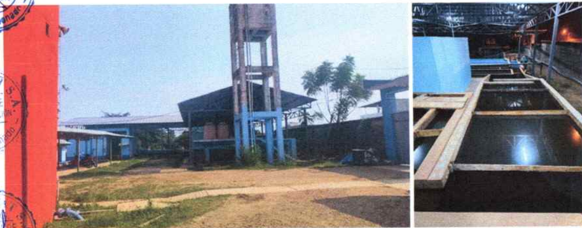
Imagen 1. Vista panorámica de la PTAP El Triunfo, planta de tratamiento completo (módulos cercanos) y planta de sedimentación y desinfección (modulo del fondo color celeste).
