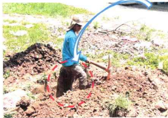
Foto: Esquinero n° 37B2 Intersección con Jr. El triunfo con Jr. Andes Mallea se hace la búsqueda de una "CRUZ", "TEE" de PVC de 110mmX110mm, "HIDRANTE" y "VALVULA DE HIDRANTE" F"F" de 110mmX110mm.
