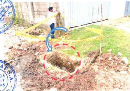
Foto: Esquinero n° 36B2 Intersección con Jr. El triunfo con pasaje Tambopata, se encontró un accesorio "TEE" de 110mmX110mm PVC.
