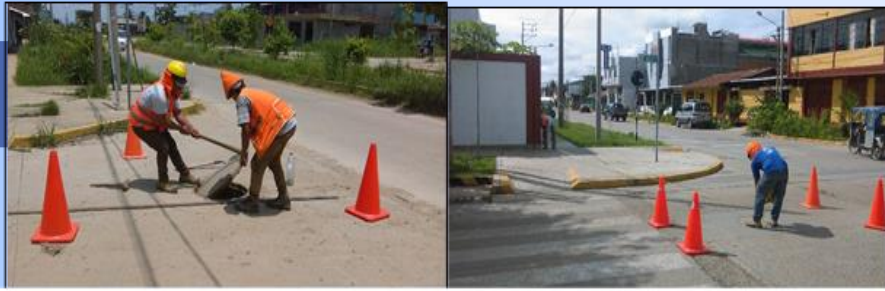
Realizando las aperturas de los buzones para realizar la toma de información respectiva.
