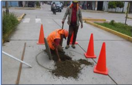
Algunos buzones aún mantenían el encofrado de tapa.
