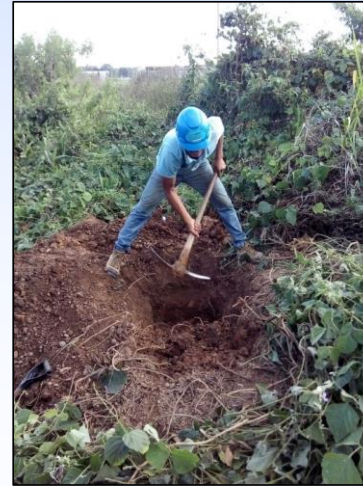
Realizando la excavación en la búsqueda de accesorios de la red de distribución de agua potable.
